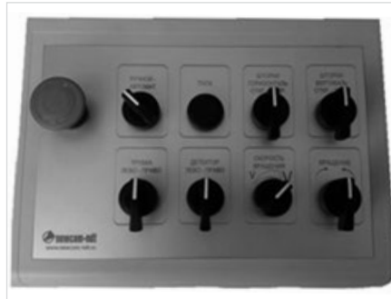
Рис. 6 — Пульт управления оператора
