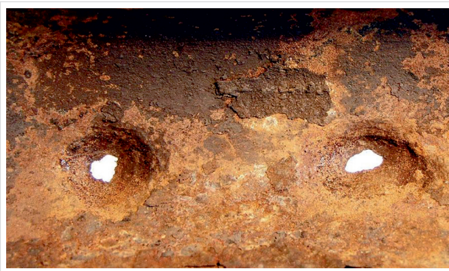
Рис. 3. Питтинговая коррозия обсадных труб нагнетательной скважины сточной воды Fig. 3. Pitting corrosion of casing pipes of a wastewater injection well
