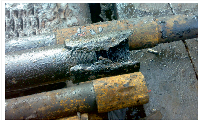
Рис. 2. Насосно-компрессорные трубы, поднятые из нагнетательной скважины сточной воды. Надпакерное затрубное пространство не было заполнено защитным составом Fig. 2. Tubing lifted from a wastewater injection well. The above-packer annulus was not filled with a protective compound
