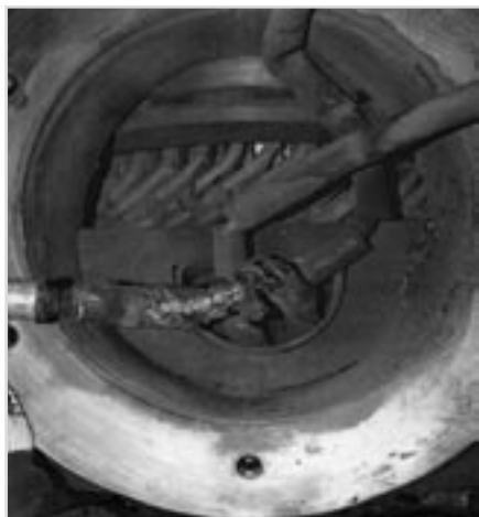
Рис. 8 Термическое повреждение изоляции силового кабеля и выводов обмоток электродвигателя в коробке выводов
