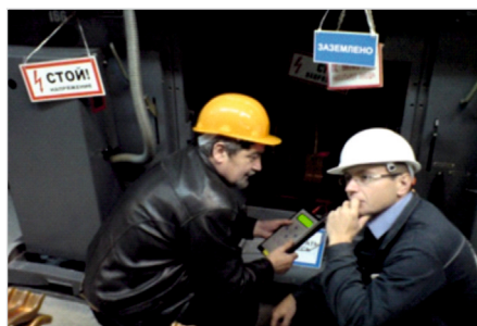
Рис. 4. Дистанционный контроль асинхронного двигателя из помещения КРУ Fig. 4. Remote control of an asynchronous motor from the switchgear room
