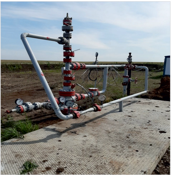
Фото 1. УСУ в устьевой обвязке скважины
