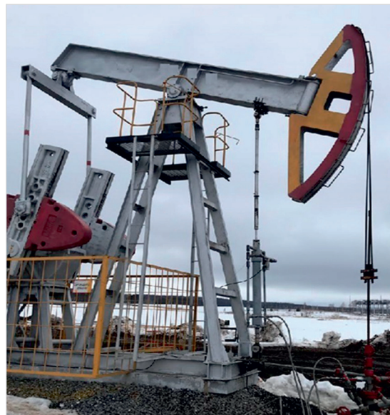
Фото 2. Компрессор скважинный, установленный на скважине
