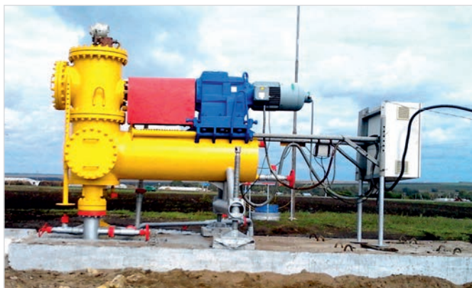
Рис. 3 — Общий вид длинноходовой глубинно-насосной установки ДГНУ-2-2,5 Fig. 3 — General view of the Long-Stroke Deep Well Pumping Unit DGNU-2-2.5
