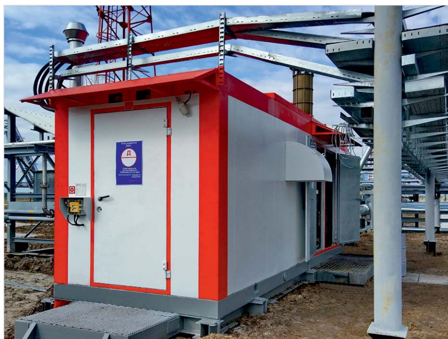
Фото 2. Модернизированная пусковая компрессорная установка для Восточно-Перевальной ГТЭС
