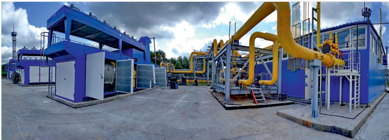
Фото 5. Система комплексной газоподготовки и газоснабжения Прегольской ТЭС
