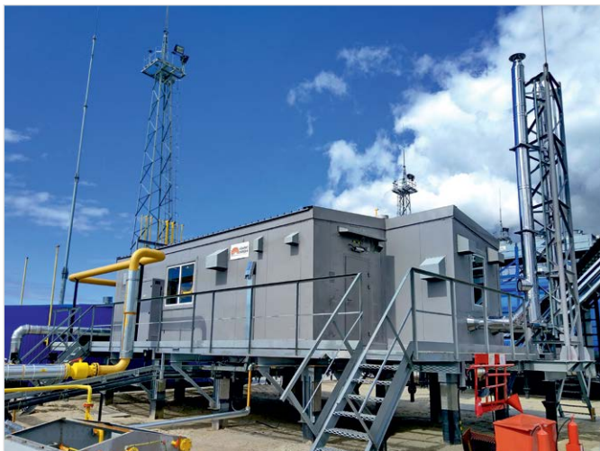
Фото 9. Установка подготовки ПНГ для энергокомплекса Баркувского месторождения на Ямале
