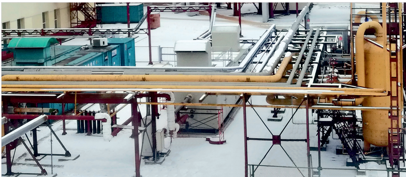
Фото 7. Дожимные компрессорные станции на площадке газового хозяйства ПГУ-230
