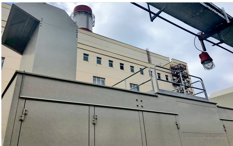
Фото 2. Новая ДКС топливного газа от компании ЭНЕРГАЗ
