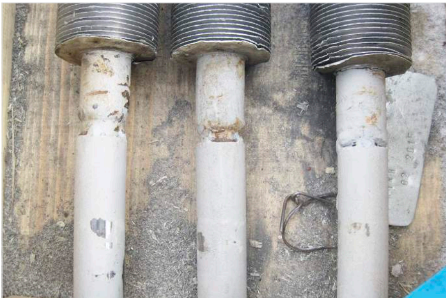
Недопустимые дефекты покрытия корпуса термостабилизатора, наличие ржавчины
