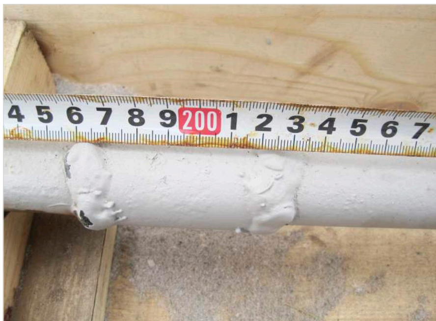
Несоответствие сварных швов нормативным требованиям
