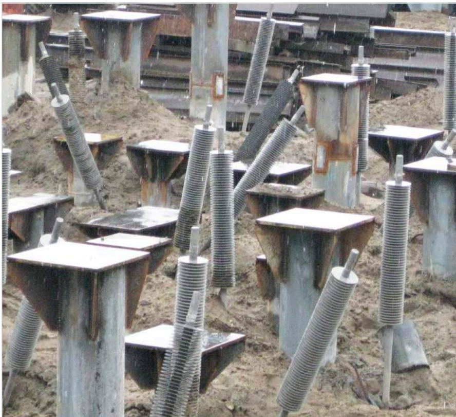
Некачественная установка термостабилизаторов
