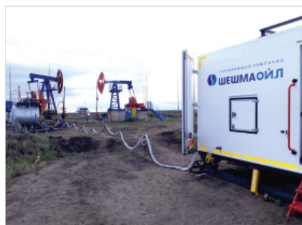
Рис. 1. Установка ПКН-Э на скв. № 3736 Fig. 1. PKN-E unit at the well No 3736
