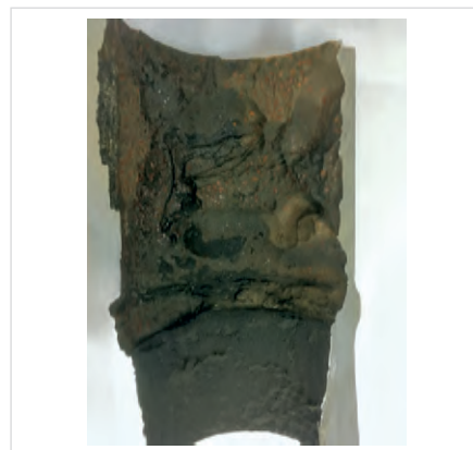
Рис. 1 — Характерные для углекислотной коррозии повреждения внутренней поверхности трубопроводов обвязки скважин (скв. 2А151)
