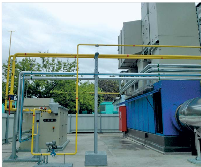
Фото 1 — МГКУ «ЭНЕРГАЗ» в составе энергоцентра Минского комбината силикатных изделий
