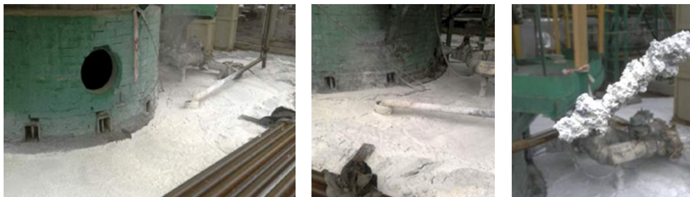
ОАО «ЯНОС», отложения слитые из дренажной емкости Е-1
