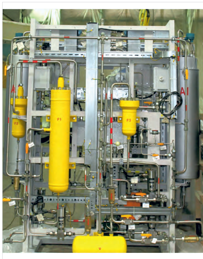
Рис. 5 — Установка подготовки импульсного газа УПИГ-00.000-30 (вид сзади)
