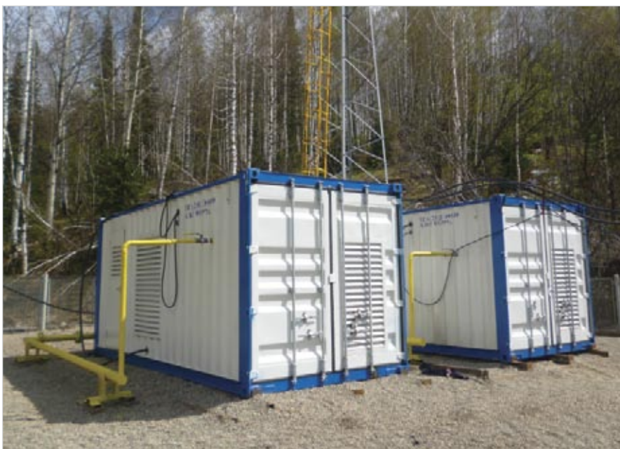
Рис.2 — Блочно-модульная станция ТГА 25/20 Э99 на объекте
